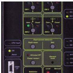
Informacje podawane na płycie czołowej urządzenia
