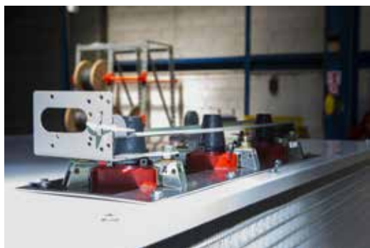
Łącza wysokiego napięcia
