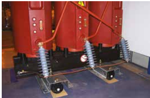
Wysokonapięciowe ochronniki przepięciowe w dolnej części
